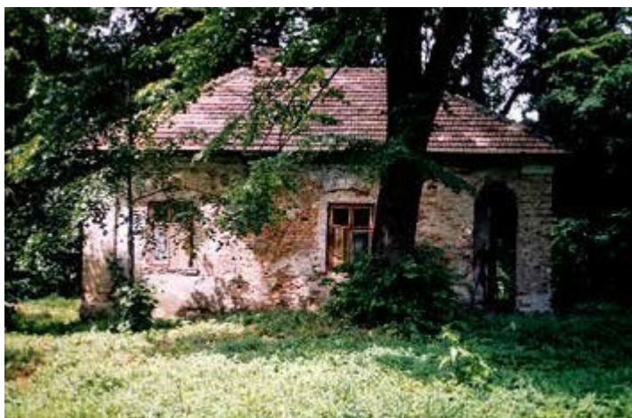
Ryc. 9. Oficyna mała w trakcie prac remontowych, lata 90. XX w., fot. J. Piórecki
