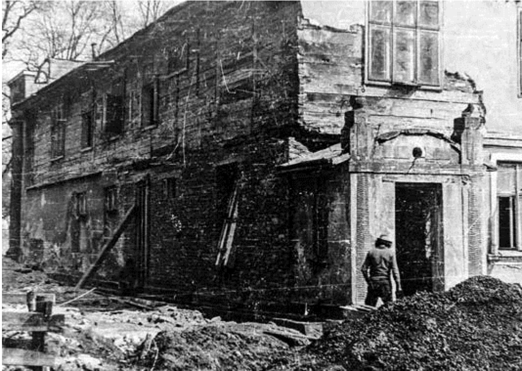
Ryc. 16. Dwór, elewacja zachodnia i północna, w trakcie remontu, 1978, fot. ze zbiorów Arboretum Bolestraszyce
