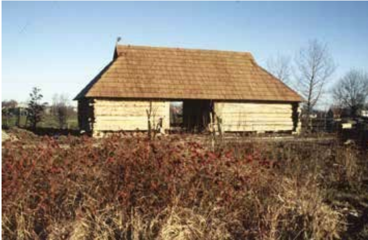
Ryc. 44. Taras dolny na dawnych błoniach, prace przy ustawieniu zabytkowej stodoły z Cieszanowa, lata 90. XX w., fot. ze zbiorów Arboretum Bolestraszyce
